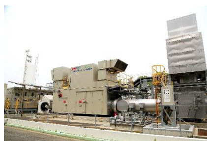
水素 CGS 実証プラント
