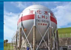
液化水素貯蔵タンク
