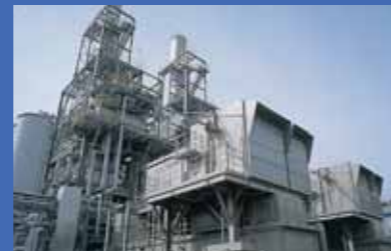
コンバインドサイクル発電設備
