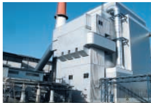
日本甜菜製糖岐阜室工場向け石炭焚自家発電設備
