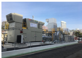
水素発電実証施設 (神戸)
