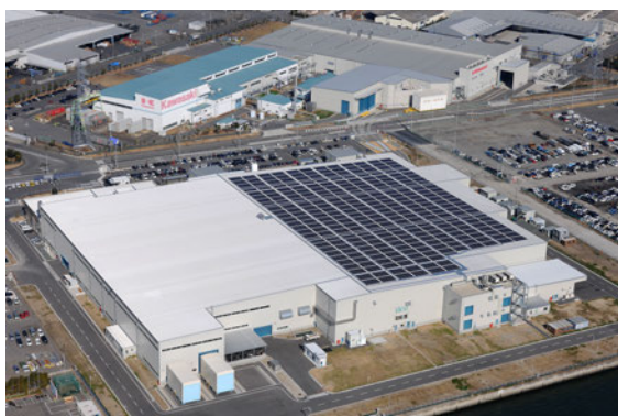
名古屋第一工場 750kW発電設備
