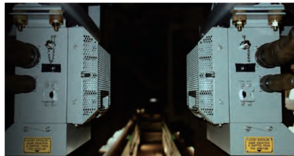
軌道遠隔監視システム
