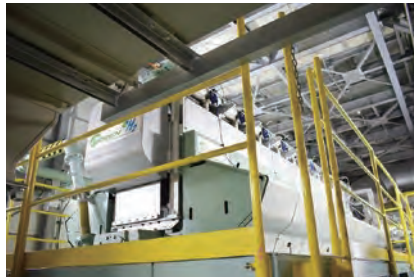
水素30%混焼ガスエンジン
