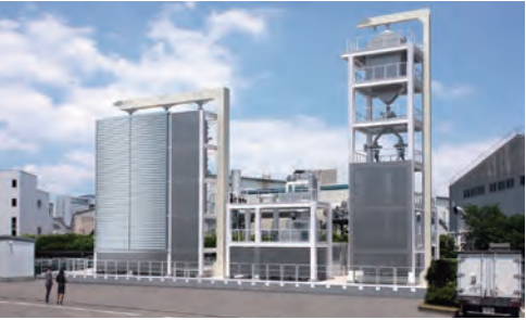
DACおよびPCCの新型実証設備
