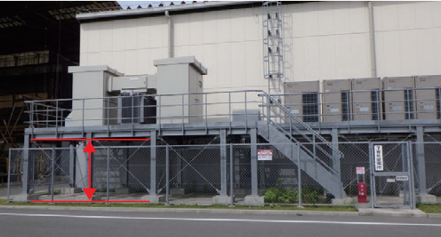
変電所 (神戸工場内)
