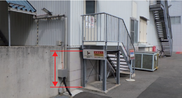
受電所 (神戸工場内)
