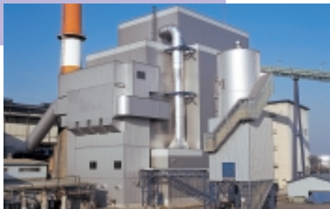
日本甜菜製糖芽室工場向けボイラ発電設備
