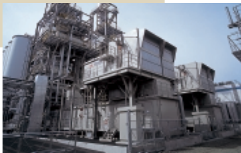
自社開発ガスタービン「L20A」搭載コンバインドサイクル発電設備
