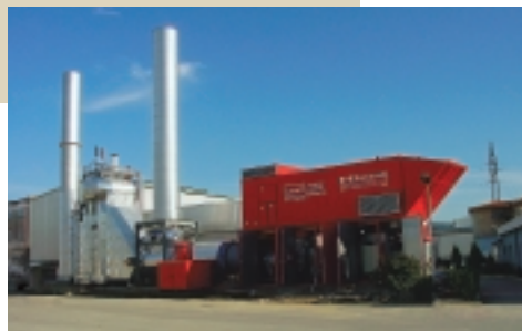
トルコ向けガスタービンコージェネレーション設備
