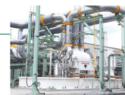
遠心式水素圧縮機の実証設備
