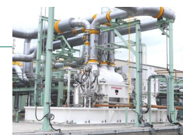
遠心式水素圧縮機の実証設備
