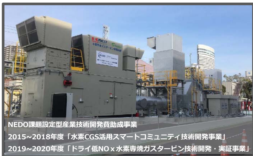
水素CGSエネルギーセンター
