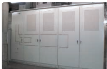
大阪市交通局 千日前線北巽変電所
