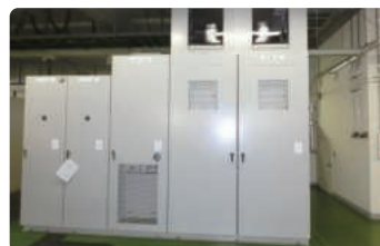
札幌市交通局 中の島変電所、鉄北変電所
