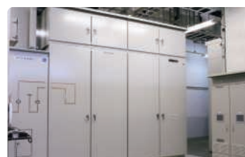
大阪市交通局 御堂筋線 中津変電所
