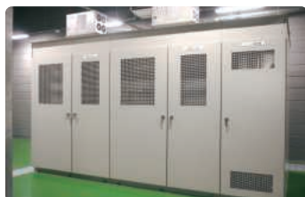
東京モノレール 品川変電所
