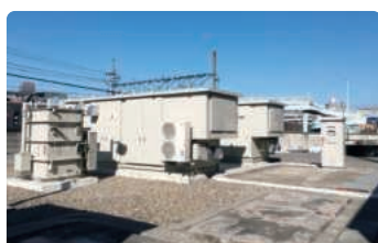
JR東日本 東北本線 久喜変電所
