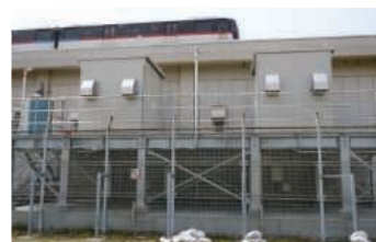
東京モノレール 多摩川変電所
