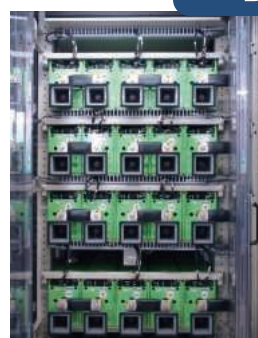
BPSキャビネット内部
