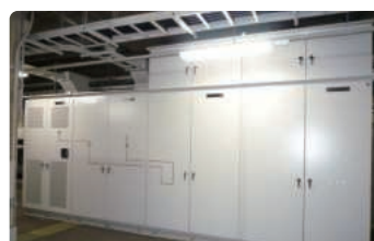
大阪市交通局 四つ橋線 北加賀屋変電所
