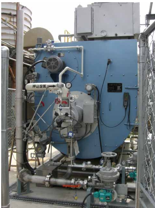
新開発の都市ガスと副生水素の混焼システム
