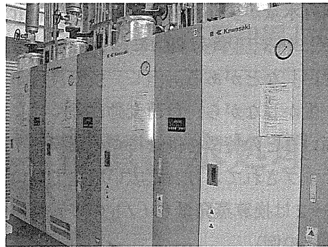
写真-3 換算蒸発量 2 t/h 小型貫流ボイラ 4 台の設置例
