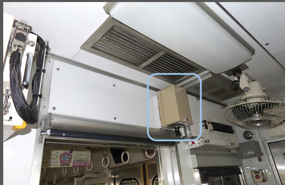
ワンマンツーマン切替スイッチを設置
