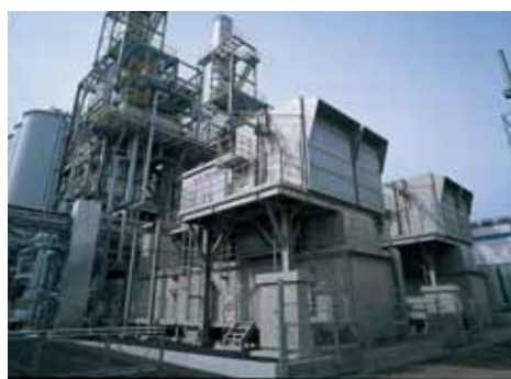
50MW コンバインド
