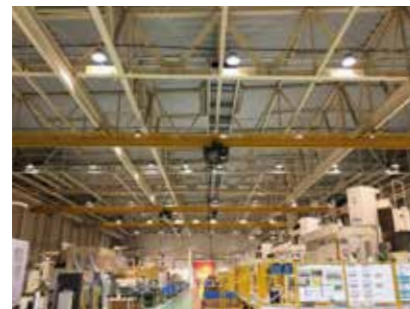
図4：工場棟の照明をLED化(西神工場)
