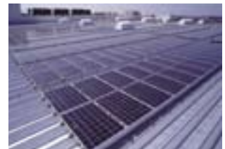
コアパーツ工場太陽光発電設備
