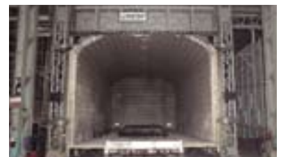
150t都市ガス焚き熱処理炉
