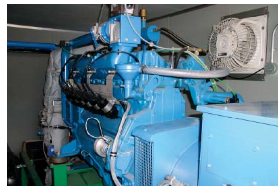
ガスエンジン発電機
