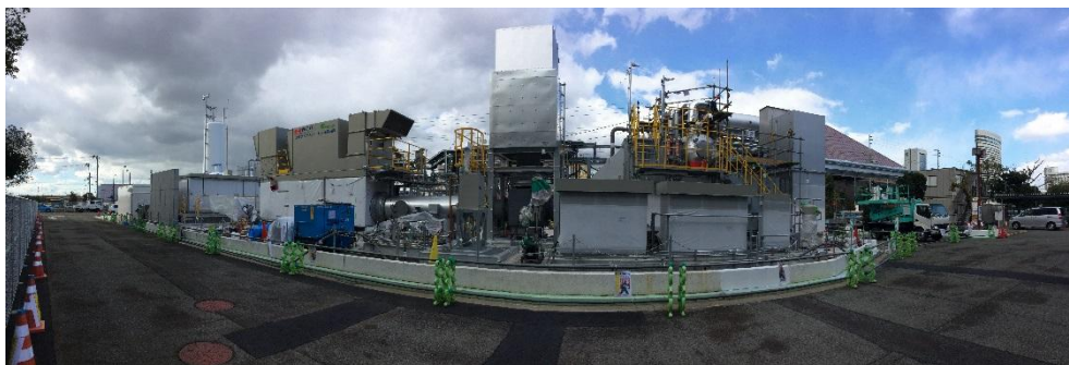
図1 水素コジェネレーションシステムのプラント
