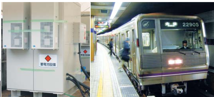
「ギガセル」を用いた「鉄道システム用地上蓄電設備」(左)の実証実験が行われた大阪市営地下鉄・谷町線(右)。
