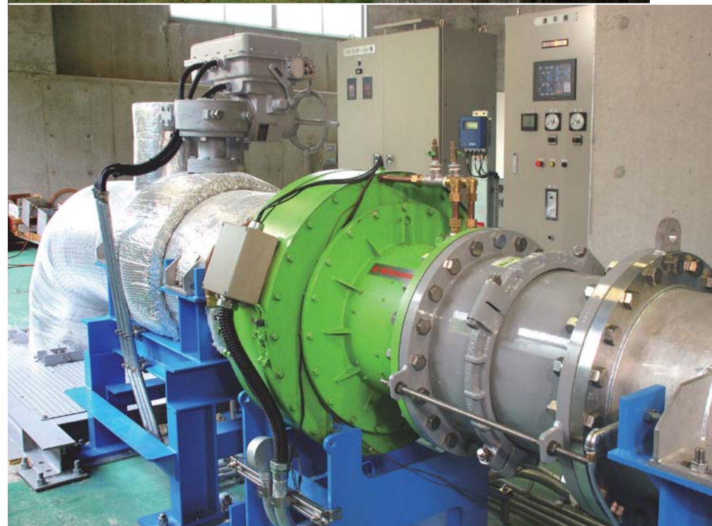
上:開発した「小水力発電装置(リング水車)」の実証試験は、兵庫県内の多目的ダムの放流施設を利用して行なわれている。 下:放水管のバイパス配管に設置された発電装置(出力40kW、緑色の部分)。
