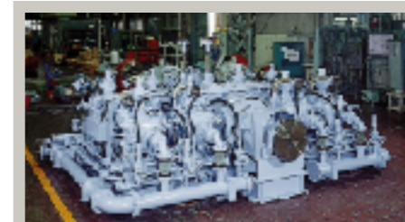
泵组 Pump unit
