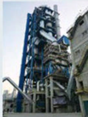
セメントプラント 排熱発電設備
