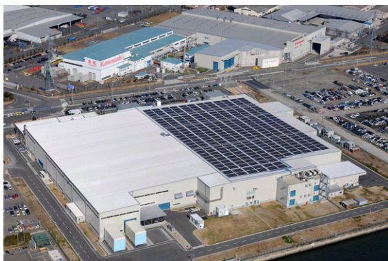
名古屋第一工場 750kW発電設備
