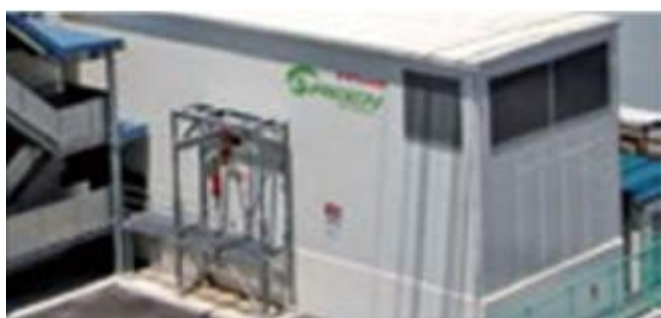
神戸工場の自家発電設備
