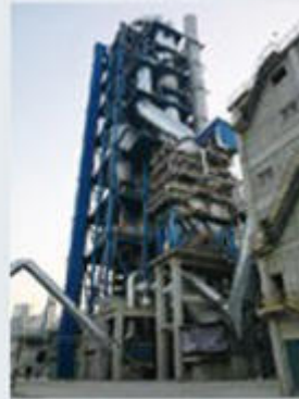
セメントプラント 排熱発電設備
