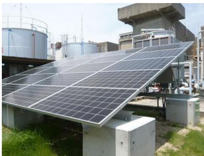
明石工場の太陽光パネル
