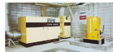
1976 国産初のガスタービン発電設備 「PU200」開発
