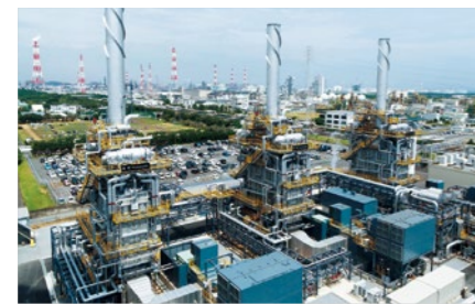
自社開発の発電出力100MW級 コンバインドサイクル発電プラント
