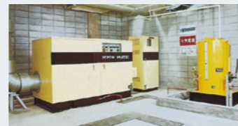
1976 国産初のガスタービン発電設備 「PU200」開発
