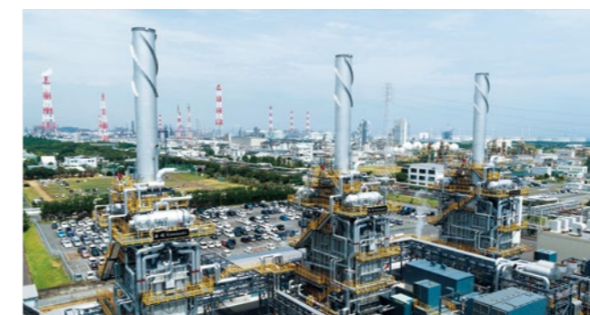
自社開発の発電出力100MW級コンバインドサイクル発電プラント
