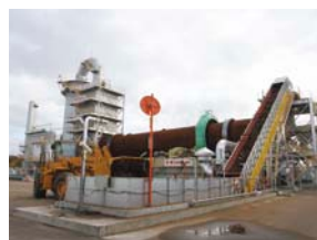
がれき焼却処理用設備
