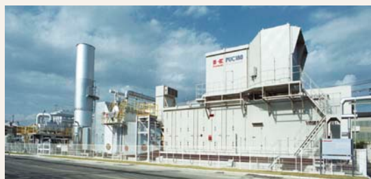
明石工場ガスタービン発電設備
