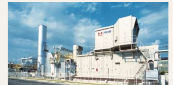
明石工場ガスタービン発電設備
