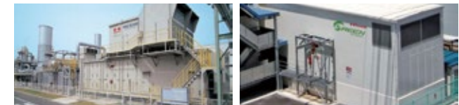
図11 明石工場の自家発電設備(ガスタービン) 図12 神戸工場の自家発電設備(ガスエンジン)
