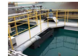
排水処理設備
