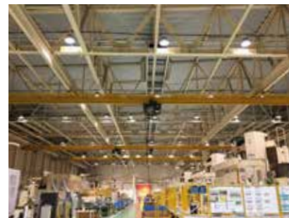
図4：工場棟の照明をLED化(西神工場)
