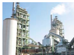
セメント排熱発電設備
