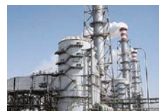
排煙脱硫装置 (サウジアラビア)
