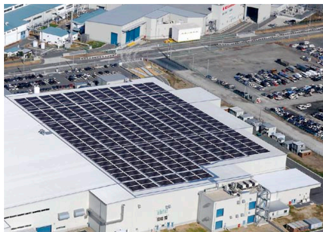
名古屋第一工場の出力 750kW 太陽光発電設備
