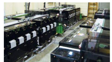
鉄道システム用地上蓄電設備(ニューヨーク地下鉄実証実験)
