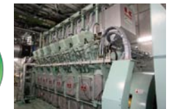
カワサキグリーンガスエンジン (神戸パワーセンター)
