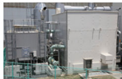
バイナリー発電設備
