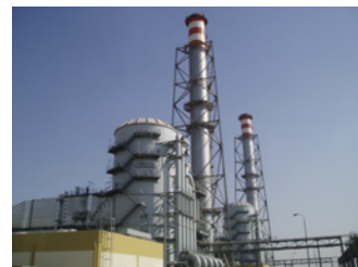
排煙脱硫装置(サウジアラビア)
