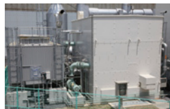
バイナリー発電設備
