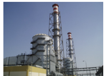
排煙脱硫装置(サウジアラビア)
