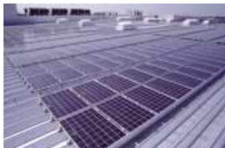
KPM本社工場(コアパーツ工場)の太陽光発電設備
