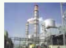
排煙脱硫装置(サウジアラビア)
