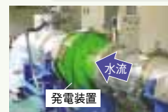
配管にセットされた発電装置(40kW)
