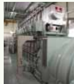
グリーンガスエンジン発電設備
