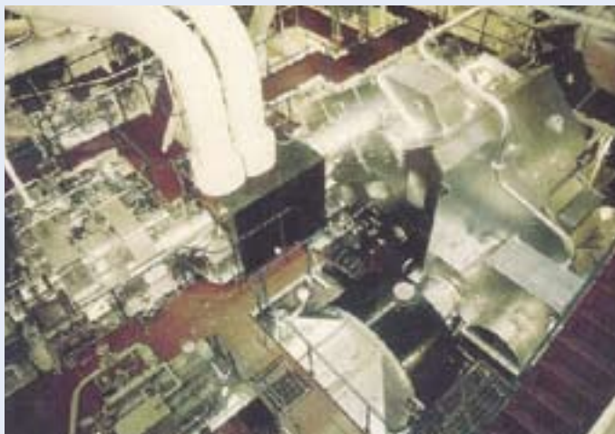
再熱タービンプラント
