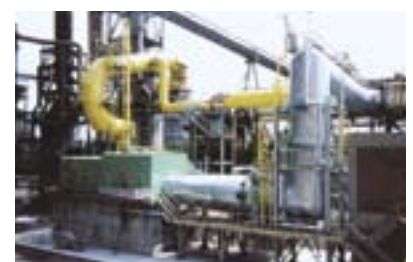
炉頂圧回収発電設備
