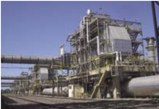
コークス炉ガス排熱発電設備
