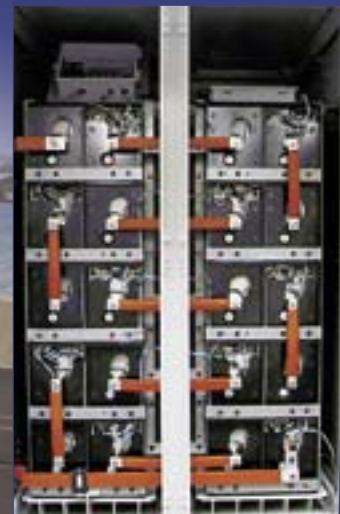
鉄道システム用地上蓄電設備
