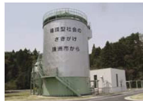
バイオメタン発酵設備
