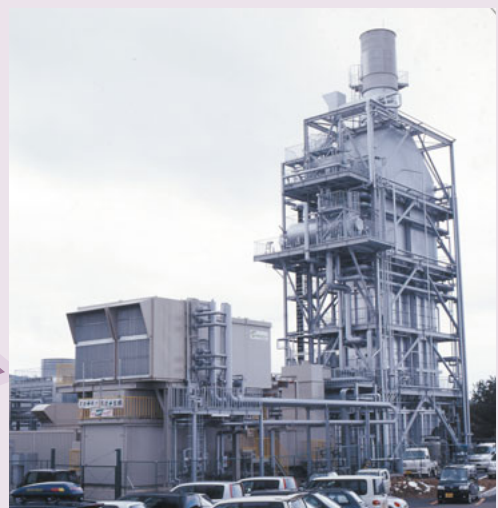
ガスタービンL20Aを搭載した25MWコンバインドサイクル発電設備
