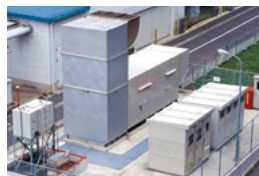
非常用ガスタービン 発電設備
