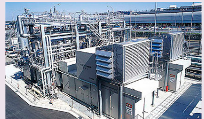
コージェネレーションシステム
