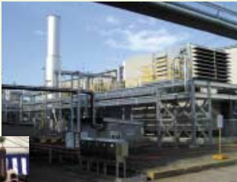
コージェネレーション設備
