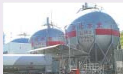
H- ロケット「液化水素貯蔵供給所」
