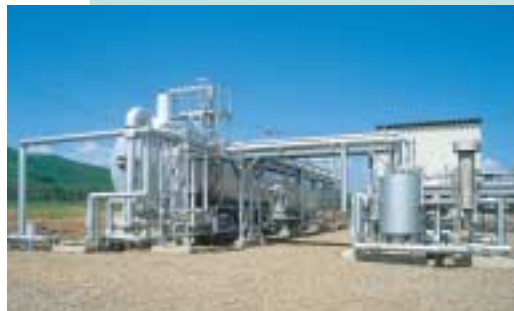
湧別町バイオガス発電設備
