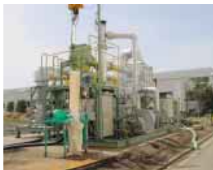
下水汚泥活性炭化設備
