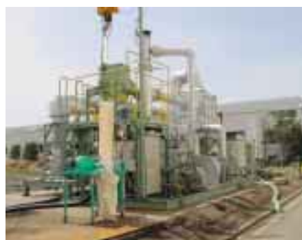
下水汚泥活性炭化設備
