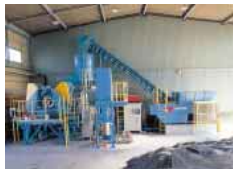
紙・プラスチック固形化燃料(RPF)製造設備
